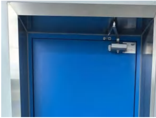
医护人员进出防护门（自动闭门）
