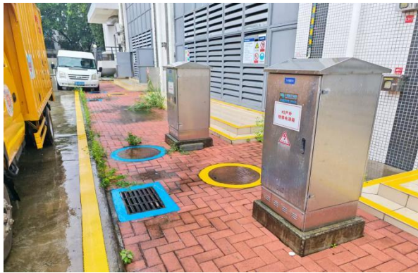
站内雨水井（蓝色）、污水井（黄色）
