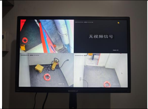
操作室内视频监控显示器
