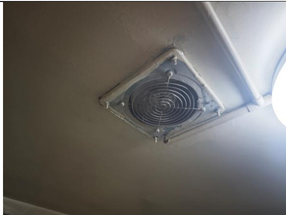
探伤室顶部排风口
