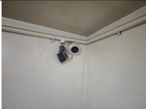
探伤室内摄像头
