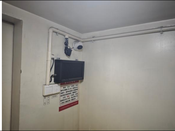
探伤室内摄像头及工作状态指示灯
