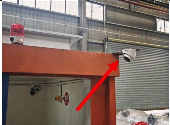
探伤室外摄像头
