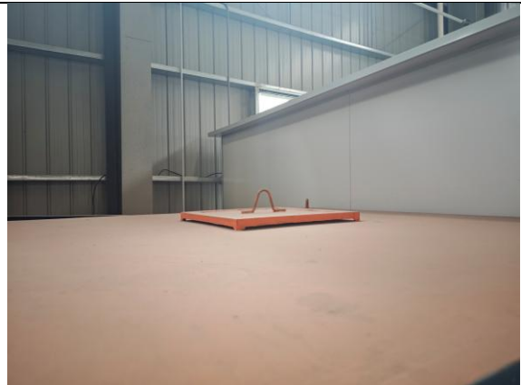
探伤室顶部排风口防护罩
