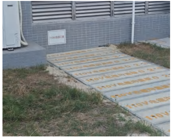
110kV 皂洲~中船 II 乙线出线
