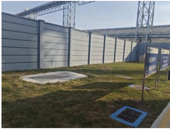
站内地埋式污水处理装置
