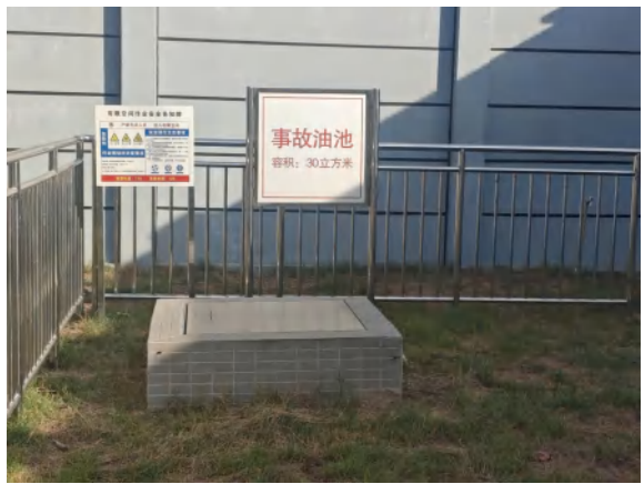
事故油池（近景）
