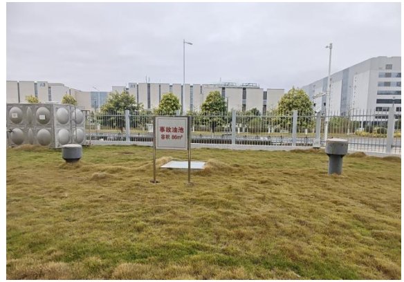
站内事故油池
