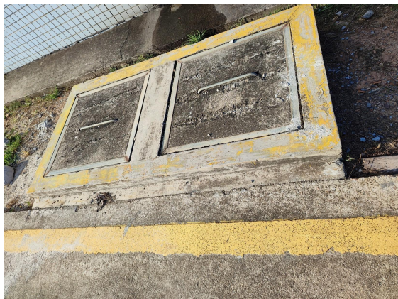
220kV 空港变电站前期已建化粪池
