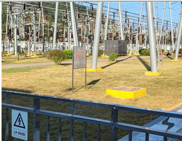
前期已建事故油池
