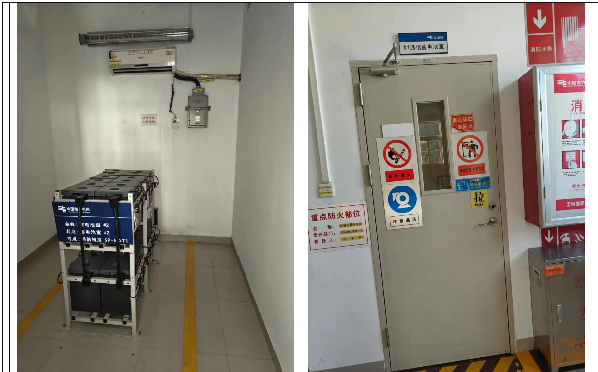
图8-1 220kV空港站蓄电池室照片
