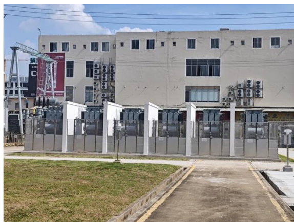
本期新建电容器组成套装置
