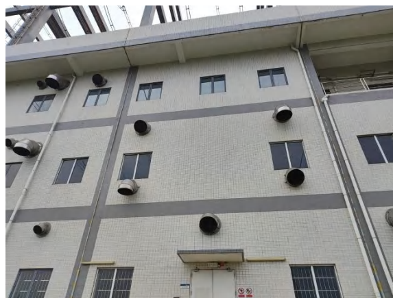
配电装置楼北侧外墙风机
