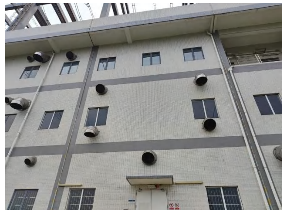
配电装置楼北侧外墙风机
