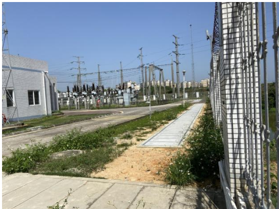
110kV 明珠变电站东南侧电缆出线侧
