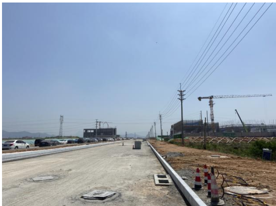
新建 110kV 电缆线路沿线
