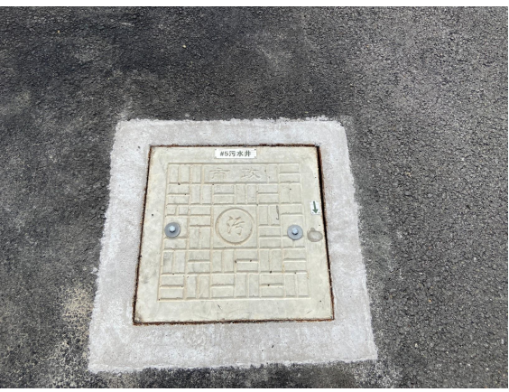
站内污水井盖
