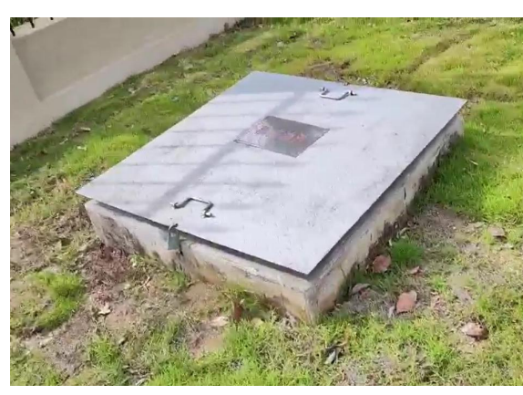
站内事故油池
