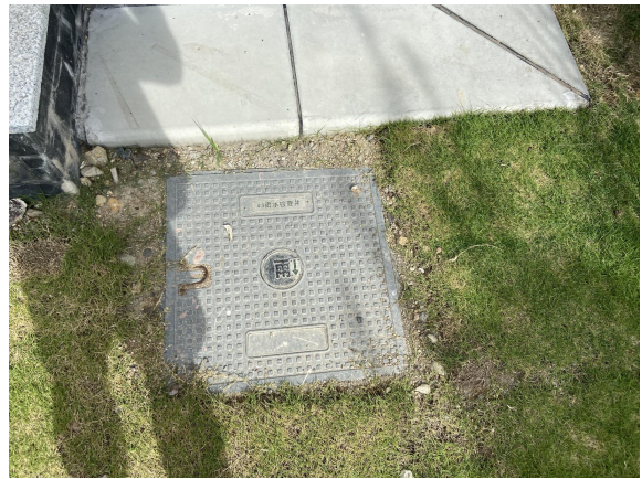
站内雨水井盖
