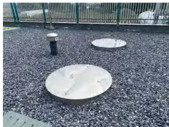
站内事故油池
