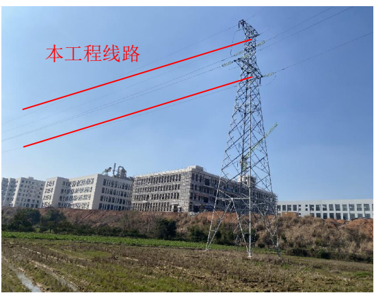
输电线路路径走向 (110kV 元江 1908 固废支线#3)
