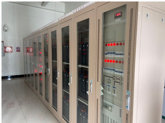
站内蓄电池屏
