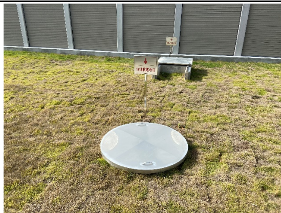
站内消防取水口
