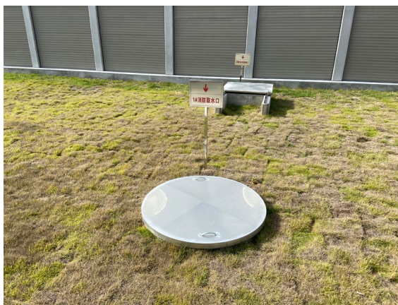
站内消防取水口
