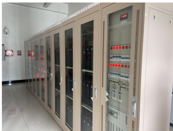
站内蓄电池屏
