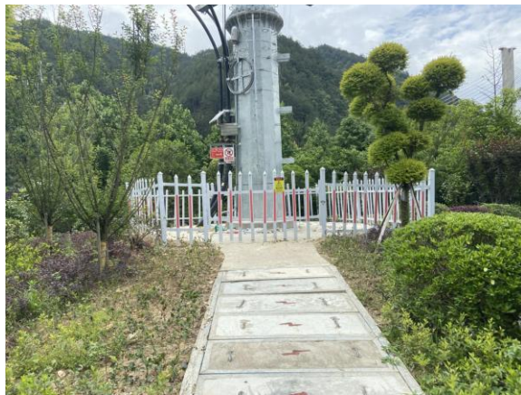
鹤溪~沙湾 110kV 线路#9 塔设置护栏
