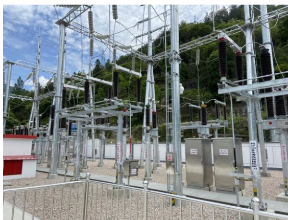
110kV 配电装置
