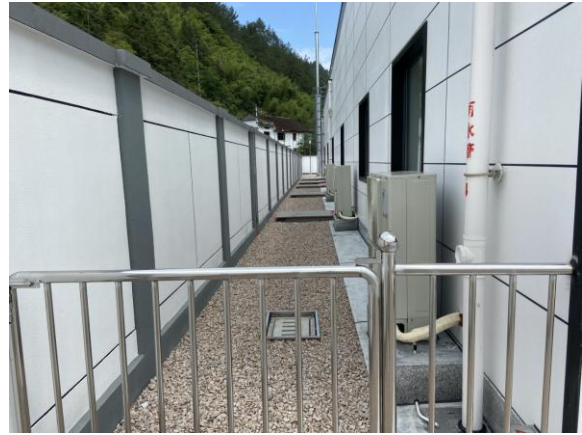
雨水排放管道
