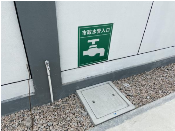
市政水管给水入口
