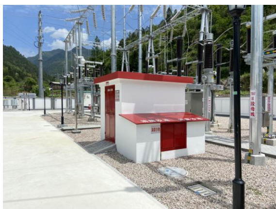
站内消防沙池
