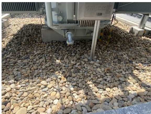
主变下方集油坑
