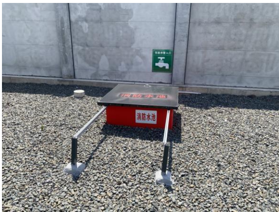
站内消防水池
