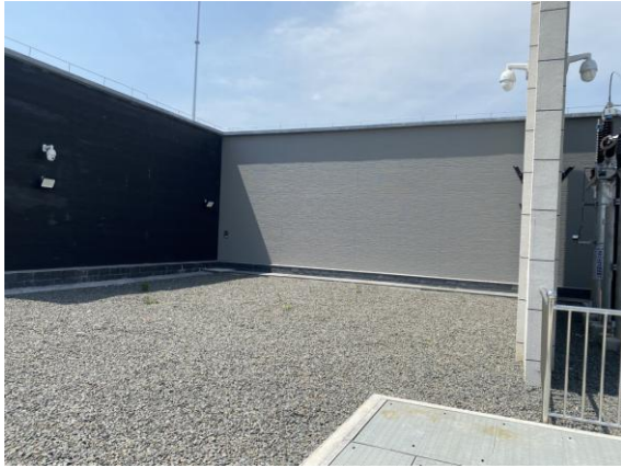
#3 主变预留场地
