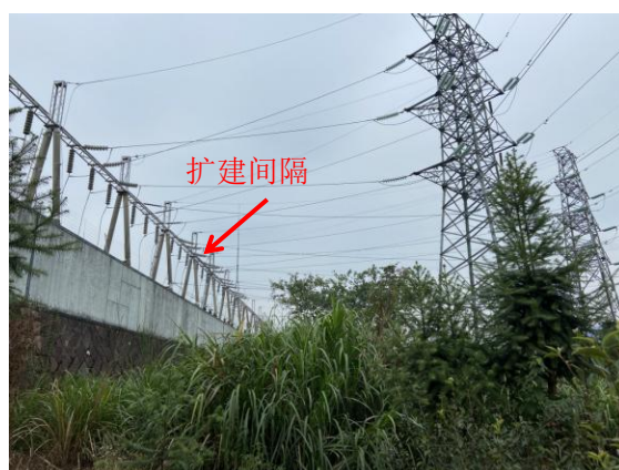
图 4-5 定阳 220kV 变电站间隔扩建侧
