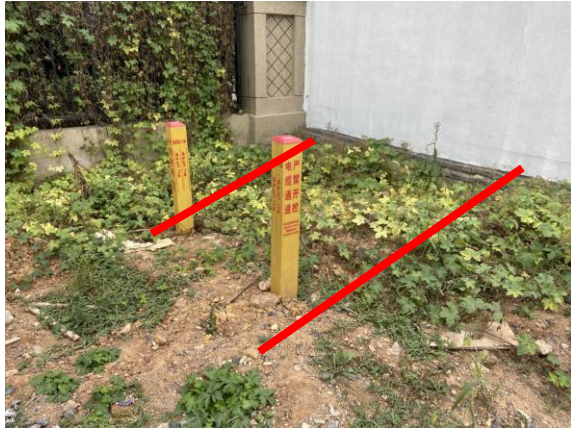
电缆线路上方设置警示桩
