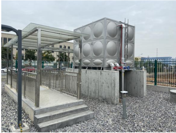
站内消防水箱
