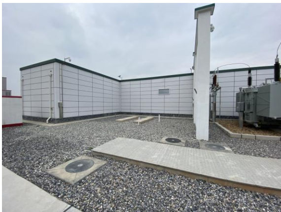
#3 主变预留场地
